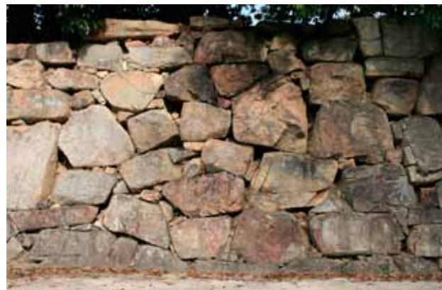
原爆後の火災による熱で損傷した中御門の石垣
